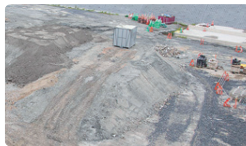
越流対策の高台
