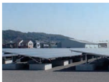
太陽光パネル
