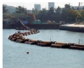
管中混合圧送管
