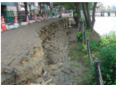
陥没した遊歩道
