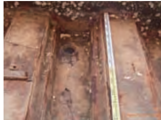
擁壁・鋼矢板（30年以上経過）
