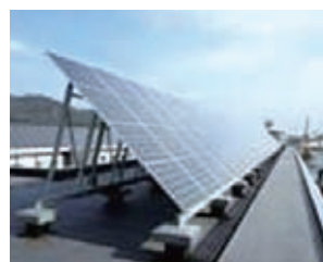
太陽光発電システム
