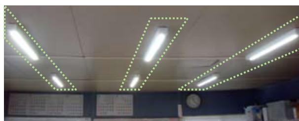
作業所内のLED照明
