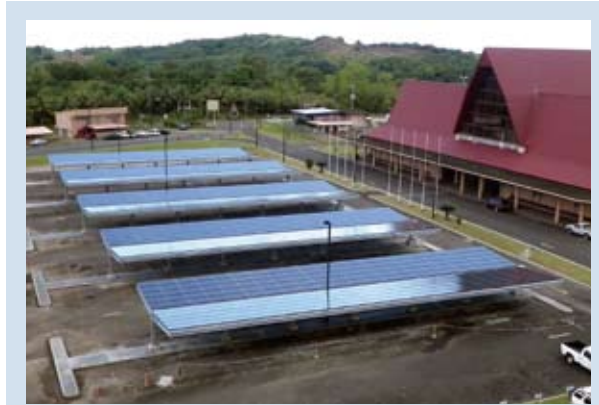
システムを設置したパラオ国際空港の駐車場
