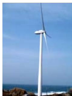
にかほ市の風力発電施設
