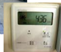
発電メーター
