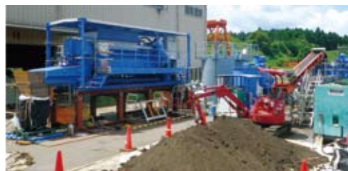
試験設備全景
